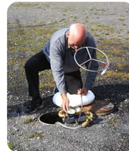
Durch den flexiblen Schlauch kann die Zähleranlage bequem neben der Schachttöffnung abgelegt und abgelesen oder der Zähler gewechselt werden.
